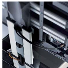
Detailansicht: Kabelführung Rückseite
